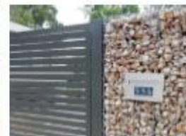
Материал: металл (сетка, решетка), бетон, щебень, гравий или камни различных фракций, сочетание материалов
